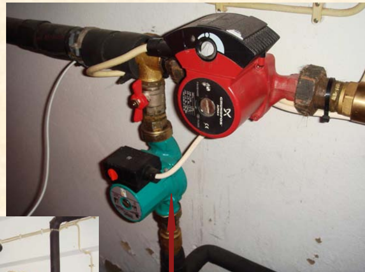
Bomba Circulação (Circuito Solar)
